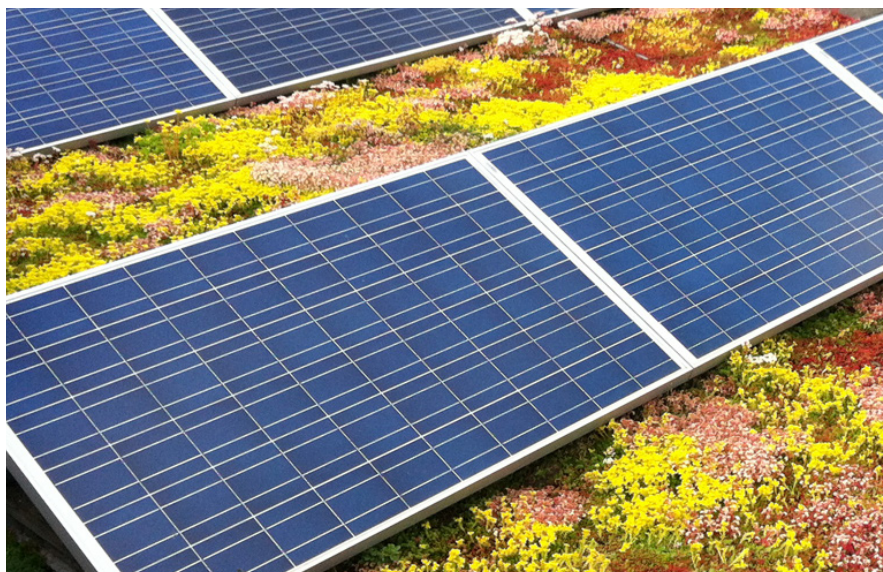
Zonnecollectoren op groen dak.
